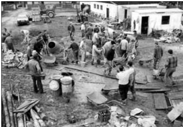
1997 - 1999 Výstavba novej farskej budovy - pohľad na priebeh betonárskych prác FOTO: J. ADAMČÍK
